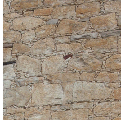
τοιχοποιία με χρήση ίδιου μεγέθους λίθων με τη χρήση χαλικώματος για αρμούς
